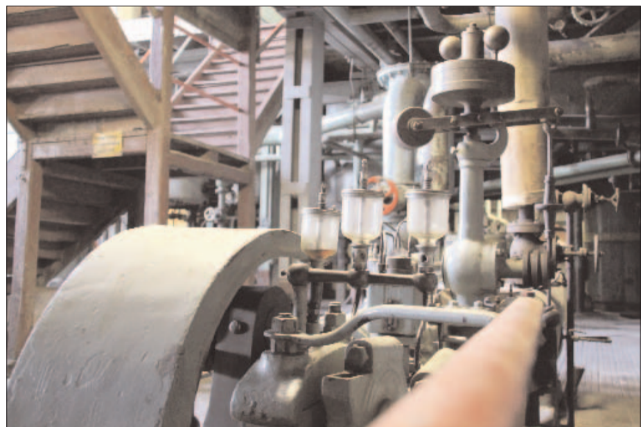
Herzstück der alten Zuckerfabriken waren die Dampfmaschinen. Dieses Detailbild zeigt Ventile und Steuerung sowie die Behälter für Schmiermittel.
